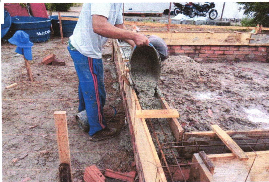
Foto 12 - COMPOSIÇÃO REPRESENTATIVA) EXECUÇÃO DE ESTRUTURAS DE CONCRETO ARMADO, PARA EDIFICAÇÃO HABITACIONAL UNIFAMILIAR TÉRREA (CASA EM EMPREENDIMENTOS), FCK = 25 MPA. AF_01/2017
