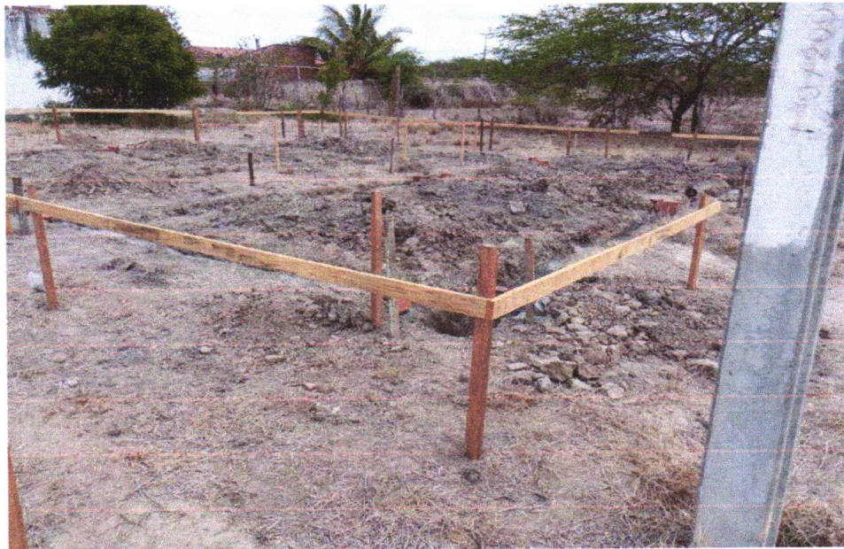
FOTO 03 - ESCAVAÇÃO MANUAL DE VALA PARA VIGA BALDRAME (INCLUINDO ESCAVAÇÃO PARA COLOCAÇÃO DE FÔRMAS). AF_06/2017
