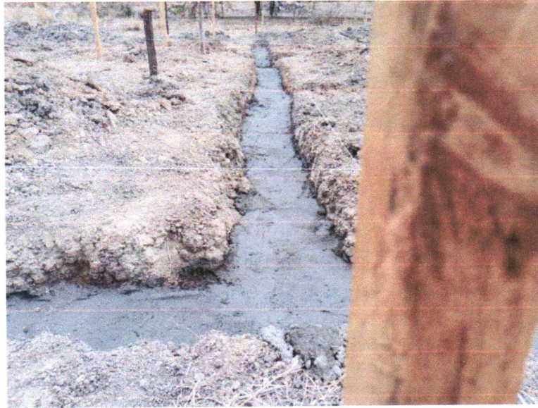
FOTO 07-LASTRO DE CONCRETO MAGRO, APLICADO EM BLOCOS DE COROAMENTO OU SAPATAS, ESPESSURA DE 3 CM
